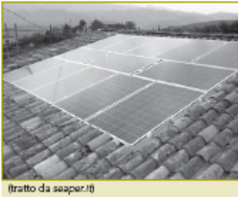
FIGURA 1 Esempio di fotovoltaico integrato nella falda di un tetto di coppi d'argilla.
